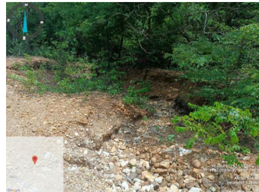
Fotografía 2-87 Registro fotográfico ocupación de cauce
