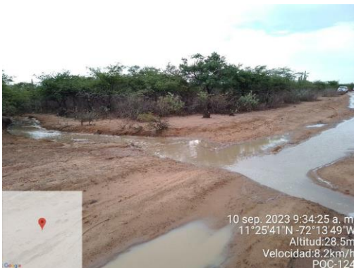
Fotografía 2-88 Registro fotográfico ocupación de cauce
