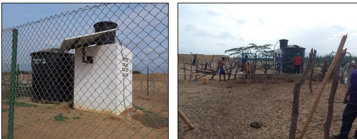
Imagen 5-1. Sistema de bombeo de agua para consumo humano y abrevadero para consumo animal en el jagüey Shou de la ranchería de Sukuluwou.
