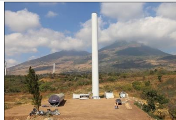
Imagen 8-6. Modificación en las formas del terreno por la construcción de plataformas de montaje 17 .
